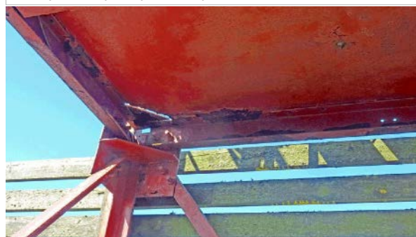
attēls nr.52; Augšējās platformas metāla lokšņu ieseguma un siju korozija. Bojāts krāsojums.
