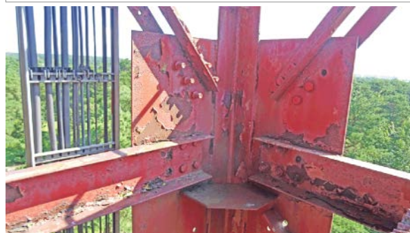
attēls nr.39; Torņa konstruktīvo elementu savienojuma mezgls. Lokāla konstrukciju korozija, bojāts krāsojums.
