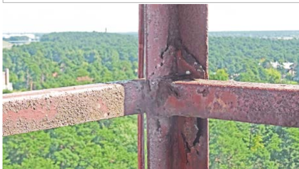
attēls nr.45; Torņa atsaīšu elementu savienojuma vietas bojājumi korozijas ietekmē.
