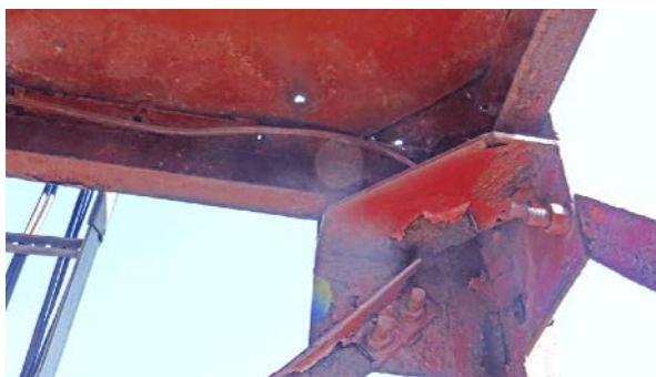
attēls nr.47; Torņa konstruktīvo elementu savienojuma mezgls. Lokāla konstrukciju korozija, bojāts krāsojums. Metāla lokšņu platformu iesegums.
