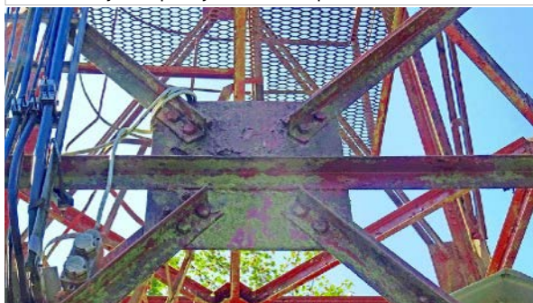
attēls nr.16; Torņa nesošo konstrukciju savienojuma mezgls. Lokālas, korozijas skartas vietas.
