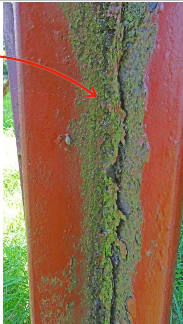
attēls nr.18; Korodējuši torņa statņu metāla konstrukcija.
