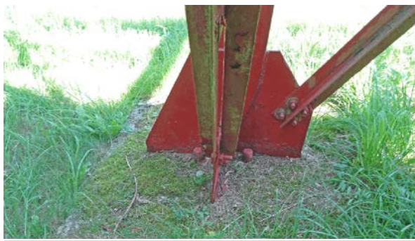
attēls nr.11; Dz/betona stabveida pamati. Piegulošās grunts līmenis, vietām, ir augstāks par pamatiem. Pamatu virsma apaugusi ar sūnu.
