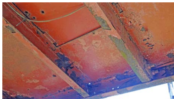
attēls nr.50; Augšējās platformas metāla lokšņu ieseguma un siju korozija. Bojāts krāsojums.
