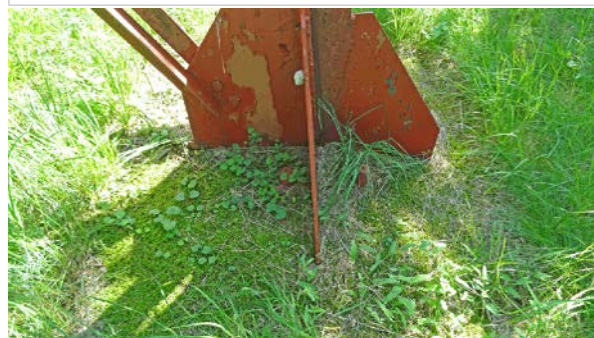
attēls nr.10; Dz/betona stabveida pamati. Piegulošās grunts līmenis, vietām, ir augstāks par pamatiem. Pamatu virsma apaugusi ar sūnu.
