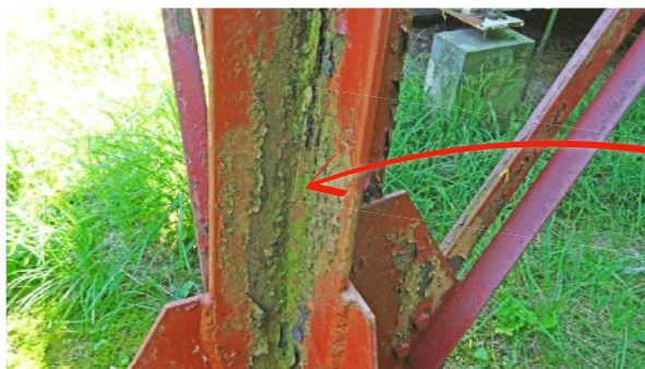
attēls nr.15; Lokālas korozijas vietas, torņa nesošajās konstrukcijās, stiprinājuma zonā ar pamatiem.
