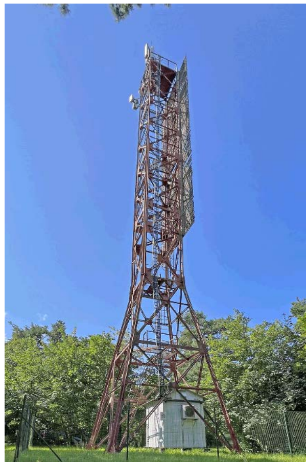
attēls nr.14; Metāla konstrukciju tornis uz stabveida dz/ betona pamatiem.
