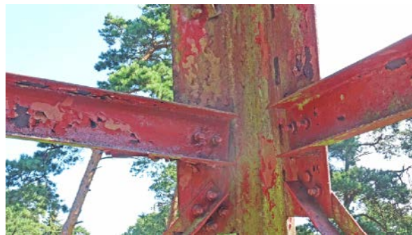
attēls nr.21; Torņa konstrukciju korozija, siju stiprinājuma zonā, bojāts krāsojums.
