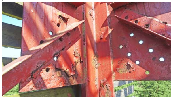
attēls nr.35; Torņa konstruktīvo elementu savienojuma mezgls. Lokāla konstrukciju korozija, bojāts krāsojums.
