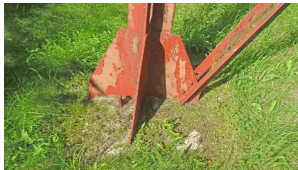
attēls nr.7; Dz/betona stabveida pamati. Piegulošās grunts līmenis, vietām, ir augstāks par pamatiem. Pamatu virsma apaugusi ar sūnu.
