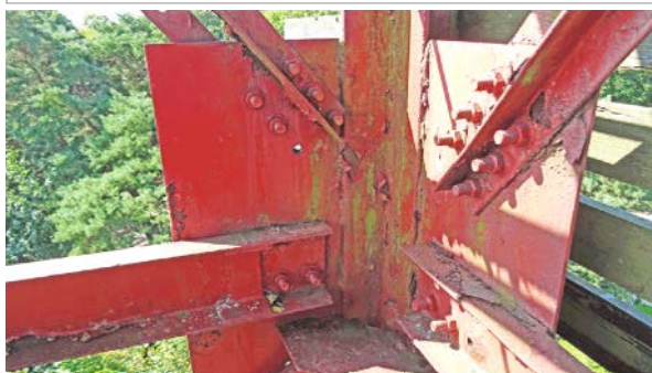
attēls nr.38; Torņa konstruktīvo elementu savienojuma mezgls. Lokāla konstrukciju korozija, bojāts krāsojums.
