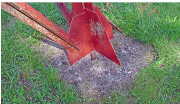
attēls nr.6; Dz/betona stabveida pamati. Piegulošās grunts līmenis, vietām, ir augstāks par pamatiem.
