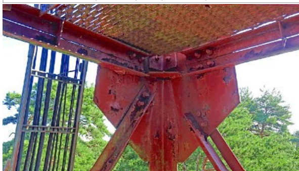
attēls nr.26; Torņa statņa konstrukciju savienojuma mezgls. Lokāla konstrukciju korozija, bojāts krāsojums. Perforēta metāla lokšņu platformu iesegums.
