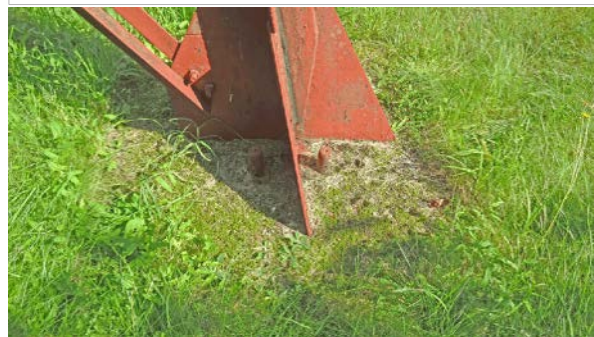
attēls nr.9; Dz/betona stabveida pamati. Piegulošās grunts līmenis, vietām, ir augstāks par pamatiem. Pamatu virsma apaugusi ar sūnu.
