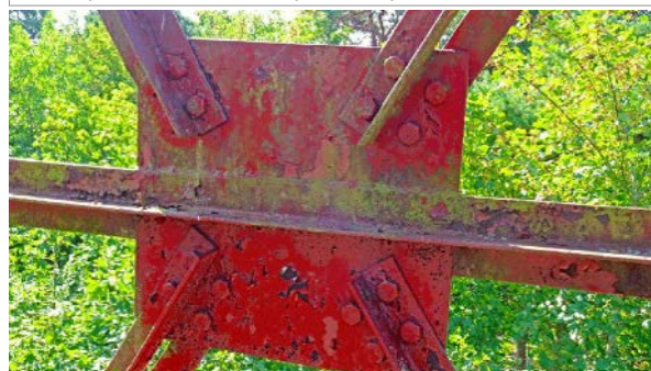
attēls nr.25; Torņa diagonālsaišu savienojuma plātnes un nesošo konstrukciju korozija. Bojāts krāsojums.
