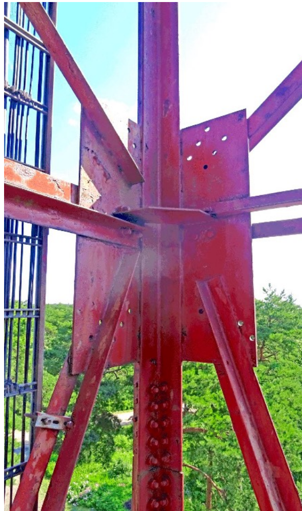
attēls nr.43; Torņa statņu elementu savienojuma mezgls. Lokāla konstrukciju korozija, bojāts krāsojums.
