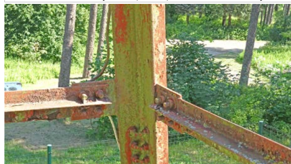
attēls nr.20; Torņa statņa un horizontālo saišu krāsojuma un korozijas bojājumi.
