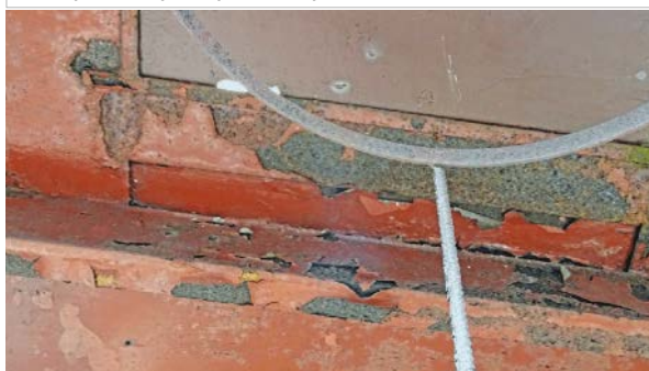
attēls nr.51; Augšējās platformas metāla lokšņu ieseguma un siju korozija. Bojāts krāsojums.
