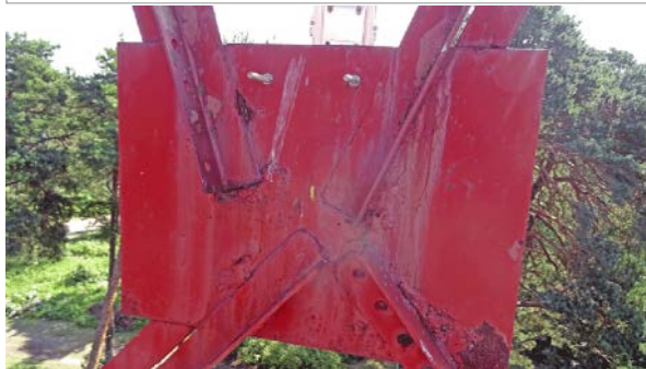
attēls nr.32; Torņa konstruktīvo elementu savienojuma mezgls. Lokāla konstrukciju korozija, bojāts krāsojums.
