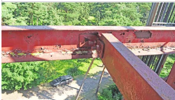
attēls nr.40; Torņa konstruktīvo elementu savienojuma mezgls. Lokāla konstrukciju korozija, bojāts krāsojums.
