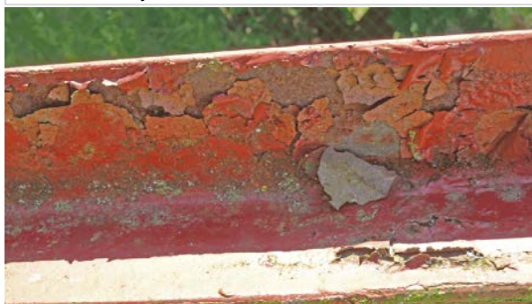
attēls nr.17; Metāla konstrukcijas krāsojuma bojājumi, korodējušās zonas.
