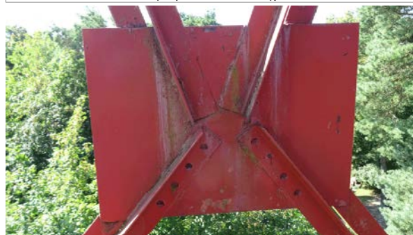
attēls nr.31; Torņa konstruktīvo elementu savienojuma mezgls. Lokāla konstrukciju korozija, bojāts krāsojums.
