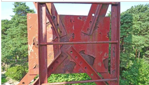
attēls nr.30; Torņa konstruktīvo elementu savienojuma mezgls. Lokāla konstrukciju korozija, bojāts krāsojums.
