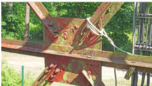
attēls nr.19; Torņa nesošo konstrukciju savienojuma mezgls. Bojāts krāsojums, lokālas, korozijas skartas vietas.
