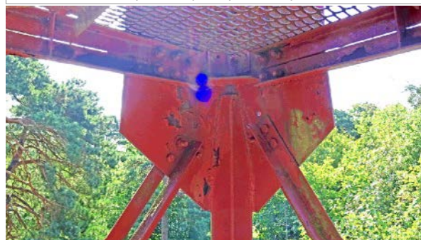
attēls nr.27; Torņa konstruktīvo elementu savienojuma mezgls. Lokāla konstrukciju korozija, bojāts krāsojums. Perforēta metāla lokšņu platformu iesegums.
