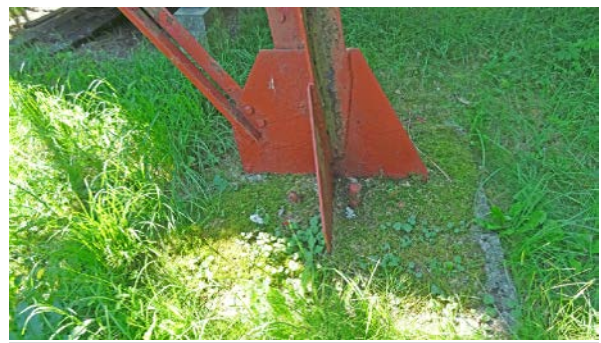
attēls nr.12; Dz/betona stabveida pamati. Piegulošās grunts līmenis, vietām, ir augstāks par pamatiem. Pamatu virsma apaugusi ar sūnu.
