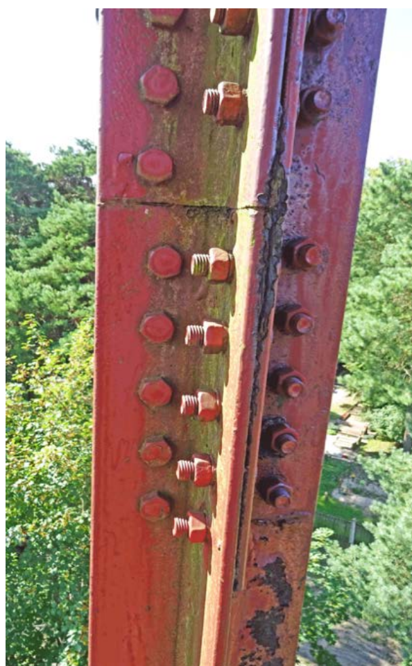
attēls nr.37; Torņa konstruktīvo elementu (statņu) savienojuma mezgls. Lokāla konstrukciju korozija, bojāts krāsojums.
