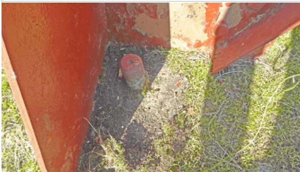
attēls nr.8; Dz/betona stabveida pamati. Piegulošās grunts līmenis, vietām, ir augstāks par pamatiem. Pamatu virsma apaugusi ar sūnu.
