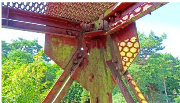
attēls nr.28; Torņa konstruktīvo elementu savienojuma mezgls. Lokāla konstrukciju korozija, bojāts krāsojums. Perforēta metāla lokšņu platformu iesegums.
