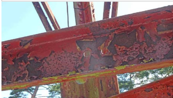
attēls nr.22; Torņa sijas konstrukciju korozija, bojāts krāsojums.
