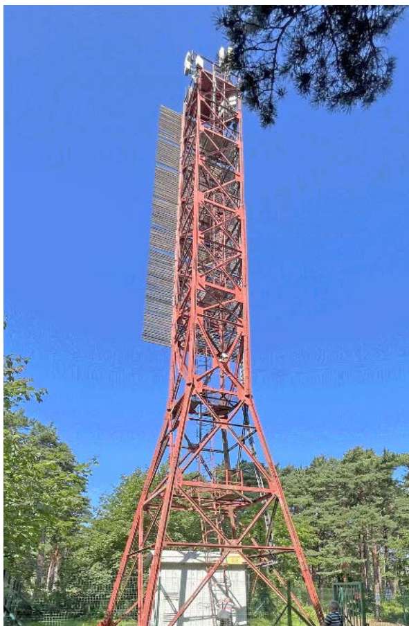
attēls nr.13; Metāla konstrukciju tornis uz stabveida dz/ betona pamatiem.
