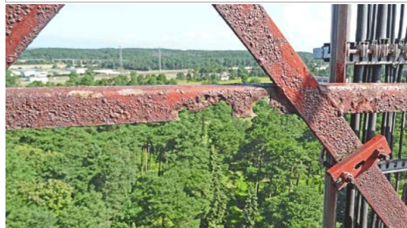
attēls nr.44; Torņa atsaīšu elementu bojājumi korozijas ietekmē.
