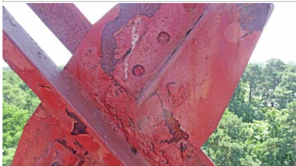
attēls nr.44; Torņa atsaīšu elementu mezgls. Lokāla konstrukciju korozija, bojāts krāsojums.
