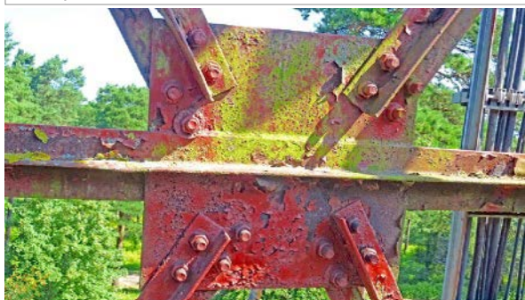
attēls nr.24; Torņa diagonālsaišu savienojuma plātnes un nesošo konstrukciju korozija. Bojāts krāsojums.
