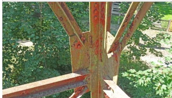
attēls nr.23; Torņa konstrukciju savienojuma mezgls. Lokās korozijas skartas vietas, bojāts krāsojums.
