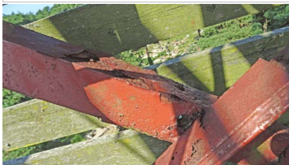
attēls nr.34; Torņa metāla atsaites elementu korozija. Bojāts krāsojums.
