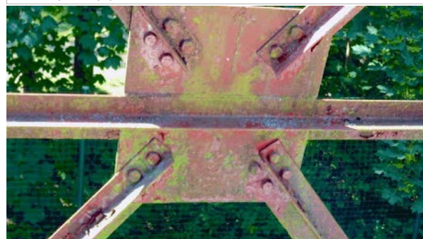
attēls nr.20; Torņa nesošo konstrukciju savienojuma mezgls. Bojāts krāsojums, lokālas, korozijas skartas vietas.
