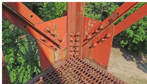
attēls nr.29; Torņa konstruktīvo elementu savienojuma mezgls. Lokāla konstrukciju korozija, bojāts krāsojums. Perforēta metāla lokšņu platformu iesegums.
