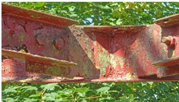
attēls nr.20; Torņa konstrukciju korozija, siju stiprinājuma zonā, bojāts krāsojums.
