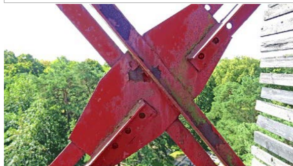
attēls nr.41; Torņa konstruktīvo elementu savienojuma mezgls. Lokāla konstrukciju korozija, bojāts krāsojums.
