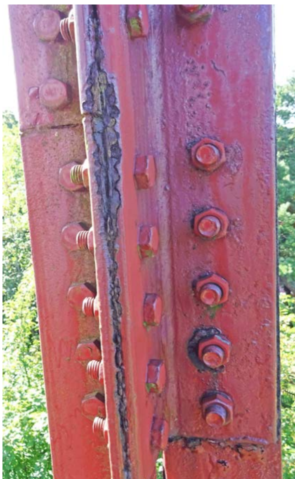
attēls nr.36; Torņa konstruktīvo elementu (statņu) savienojuma mezgls. Lokāla konstrukciju korozija, bojāts krāsojums.
