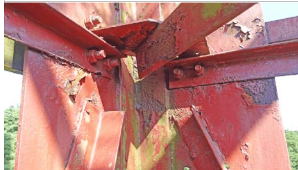
attēls nr.33; Torņa konstruktīvo elementu savienojuma mezgls. Lokāla konstrukciju korozija, bojāts krāsojums.
