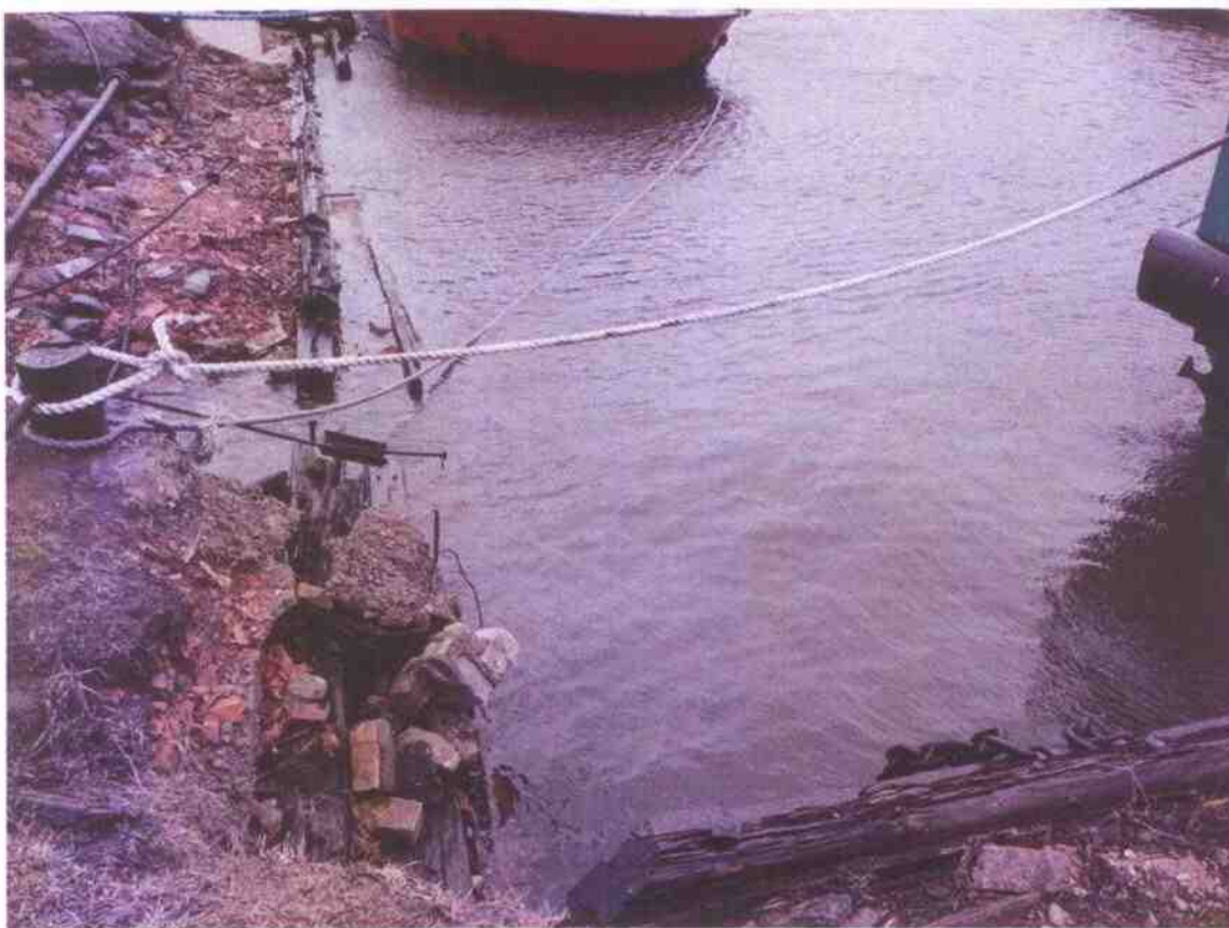
2. attēls. Ventspils brīvostas pārvaldes kuģu stāvēšanas piestātņu fasādes pašreizējais stāvoklis.
