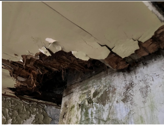
4.6.2.att. ZR stūrī bojāta pārseguma konstrukcija, kā arī griestu konstrukcija. Skats no apakšas, telpa Nr.3 (pēc inv.lietas datiem).
