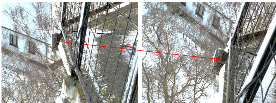
4.20.24.un 4.20.25.att. Konstruktiju apbetonējuma slāņa bojājumi, korozija, plaisas rada bīstamību, nekontrolētu betona atslāņošanu un nokrišanu.
