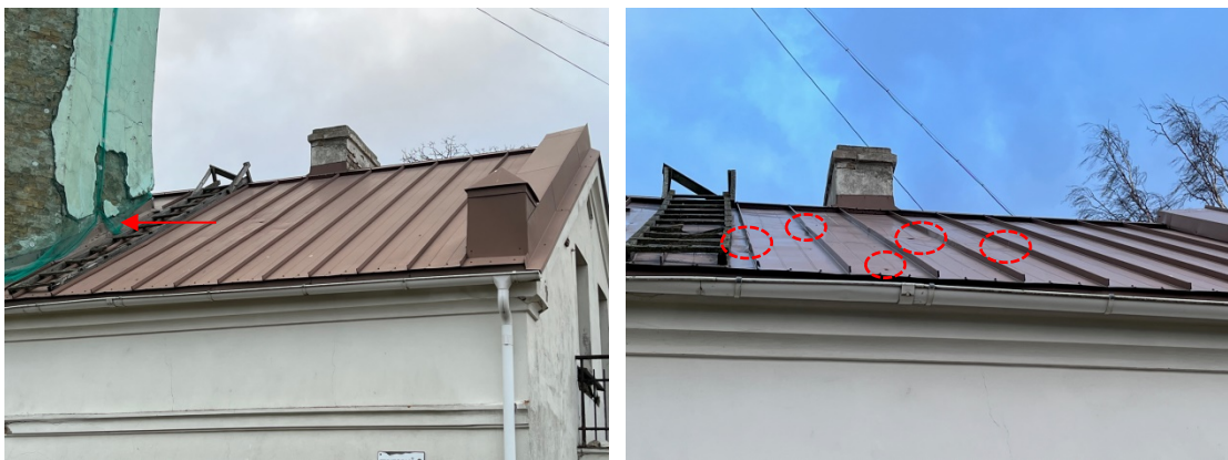
4.8.8.un 4.8.9.att. Lokāli konstatēti bojājumi, caurumi, deformācija smaguma ietekmē un neblīvi savienojumi ar torņa sienām.
