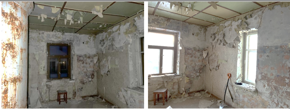
4.18.1.un 4.18.2.att. Tapešu apdare 1.stāva telpā, ļoti sliktā stāvoklī.
