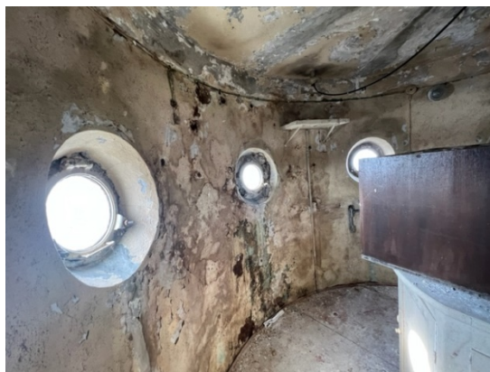
4.18.9.att. Torņa dzelzsbetona cilindra formas sienai kaļķa javas apdare, būtiski bojāta mitruma ietekmē.
