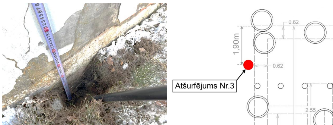
4.1.16.un 4.1.17.att. Atšurfējumā Nr.3 konstatēts, ka zem lentveida pamatiem nav betona pēda, kas sakrīt arī ar pamatu plānu.
