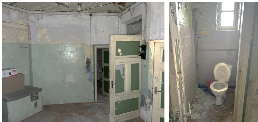
4.18.3.un 4.18.4.att. 1.stāva iekšējā apdare būtiski bojāta mitruma ietekmē.
