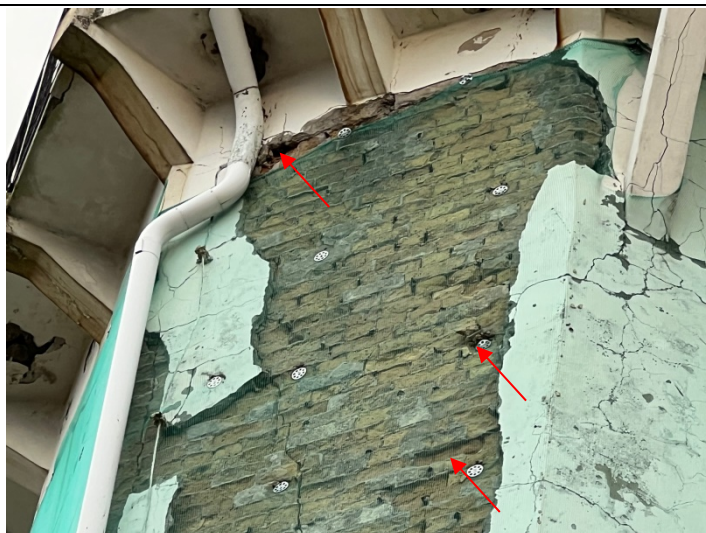
4.2.18.att. Torņa DR pusē kur atslāņojies cementa javas apmetums, tiek bojāts nesošais mūris, mūrim konstatēti izdrupumi ~3 – 4cm dziļumā.
