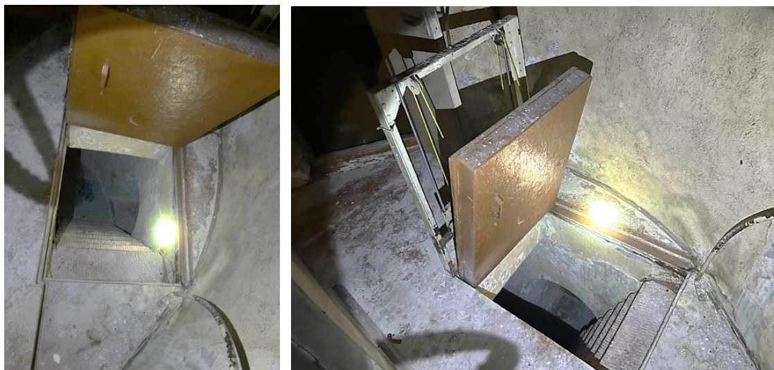
4.13.8.un 4.13.9.att. Torņa 6.stāvā izbūvēta koka konstrukcijas grīdas lūka.
