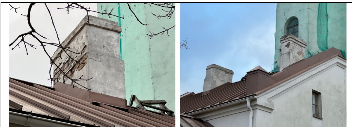
4.14.4.un 4.14.5.att. Dūmeņu ārējai daļai konstatēti apmetuma izdrupumi.
