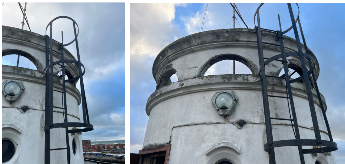
4.10.8.un 4.10.9.att. Torņa 6.stāva līmenī ārpusē izbūvētas metāla konstrukcijas apkalpes kāpnes, lai nodrošinātu piekļuvi jumtam. Kāpnēm konstatēti korozijas bojājumi. Apšaubāmas kāpņu stiprinājuma vietas.
