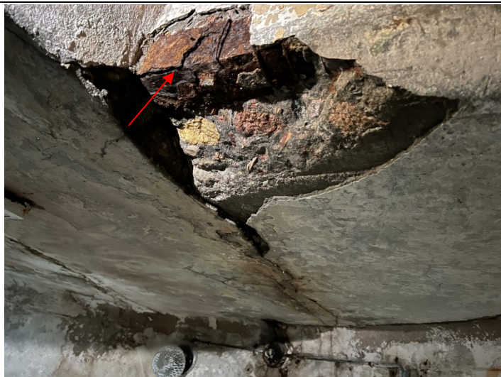
4.6.19.att. Metāla sija / leņķis ~6x6cm, konstatēta korozija, deformācija, pārrāvumi.
