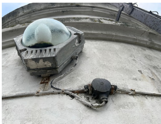
5.9.3.att. Elektrības vadi un apgaismojuma elementi neapmierinošā stāvoklī.
