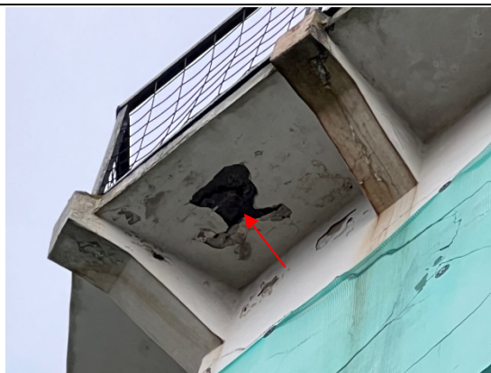
4.20.12.att. Platformas bojājums, izdrupums R pusē.
