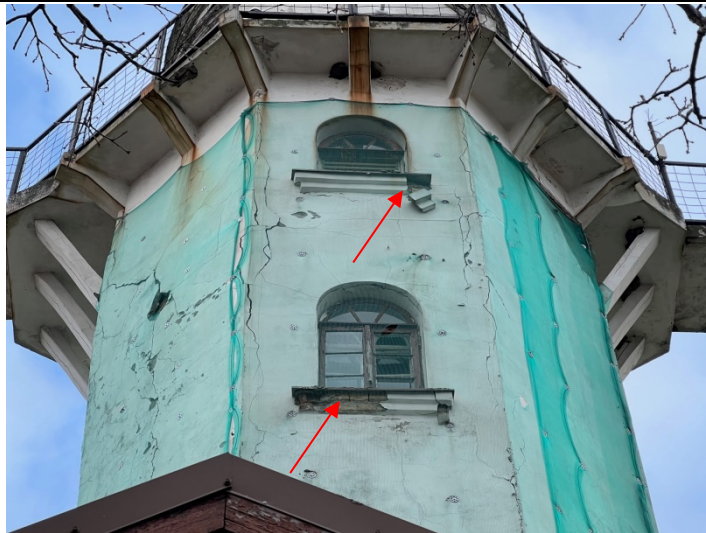
4.2.15.att. Torņa A pusē konstatēti izdrupumi dekoratīvajiem palodžu profiliem / mūra izvirzījumiem. Ārējai apdarei konstatētas plaisas, izdrupumi, bojājumi.
