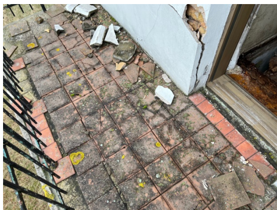
4.9.10.att. Balkonam izbūvēta flīžu grīdas segums, konstatēti bojājumi, izdrupumi, atslāņošanās. Flīžu segums sliktā stāvoklī, pilnībā viss ir jādemontē.
