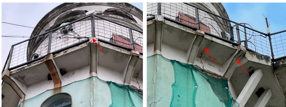
4.20.4.un 4.20.5.att. Apkalpes platformai lokāli konstatēti bojājumi, plaisas.
