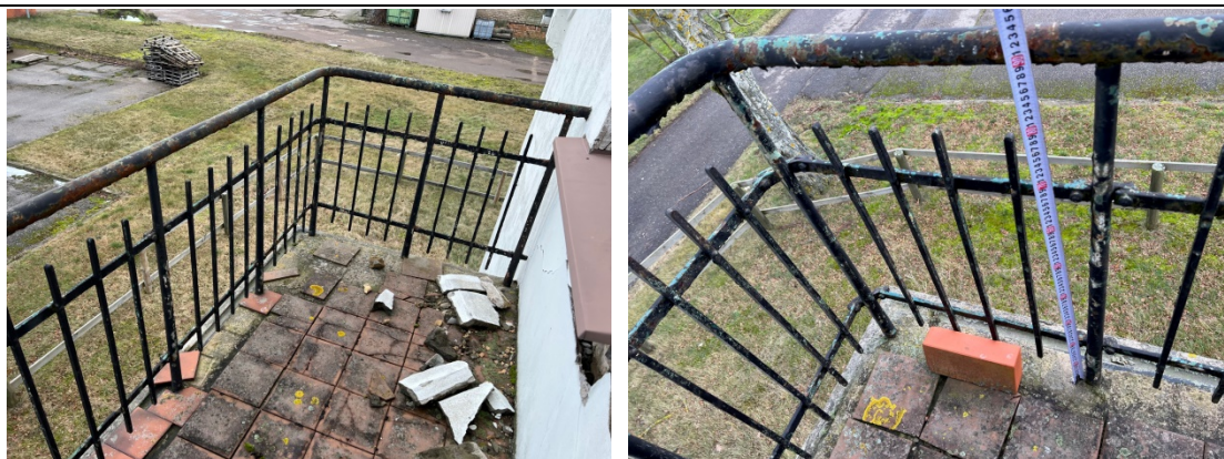
4.9.11.un 4.9.12.att. Balkonam izbūvētas metāla margas, ~92cm augstas. Nepieciešmas apstrādāt ar pretkorozijas līdzekļiem un aizsargkrāsojumu.
