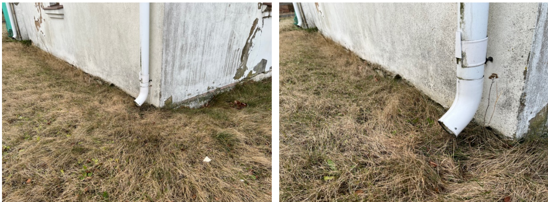
4.8.10.un 4.8.11.att. Noteksisitēma izbūvētano cinkota krāsota skārda apaļcaurlēm un notekrenēm, apmierinošā stāvoklī.
