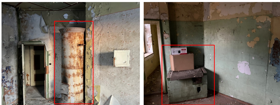
4.14.2.un 4.14.3.att. Apkures krāsns un plīts administratīvajā ēkas daļā, neapmierinošā stāvoklī, šādā stāvoklī aizliegts ekspluatēt.
