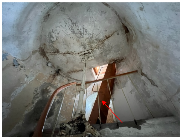
4.10.5.att. Starp 5.un 6.stāvu izbūvētas stāvas viena laida metāla konstrukcijas kāpnes.
