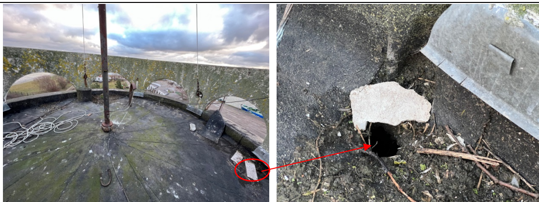
4.8.16.un 4.8.17.att. Jumta pārseguma paneļa konstrukcijā R pusē izbūvēt viena lietusūdens noteces vieta, nepieciešama tīrīšana.
