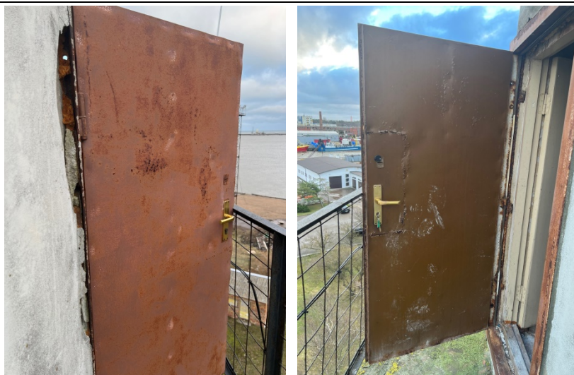
4.13.6.un 4.13.7.att. Torņa 6.stāvā izbūvētas ar metālu apdarinātas ārdurvis. Durvīm konstatēti bojājumi, korozija, deformācija.
