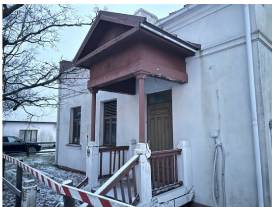
4.9.1.att. Ieejas zonu sedzošais koka konstrukcijas jumtiņš konstatēto lieveņa laukuma un margu bojājumu dēļ pirmsavārijas stāvoklī.
