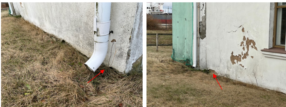
4.1.6.un 4.1.7.att. Pamatu stāvoklis R pusē. Virspamatu augstums līdz ~10cm, konstatēti izskalojumi pie lietusūdens notekcaurules. Vietām apmetuma izdrupumi.
