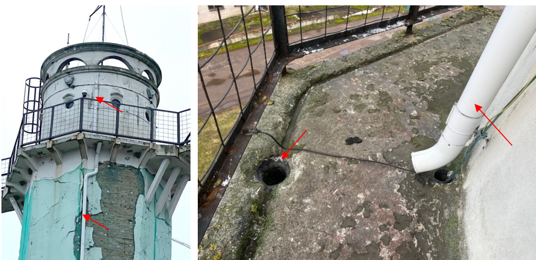
4.8.18.un 4.8.19.att. Gar torņa sienu R pusē izbūvēta cinkota krāsota skārda notekcaurule.
