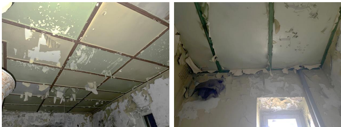
4.18.5.un 4.18.6.att. Ēkas vairākās telpās izbūvēti krāsoti pienagloti finiera griesti ar profilētām stiprinājuma līstēm, krāsojums bojāts, kā arī lokāli konstatēti būtiski mitruma radīti bojājumi, trupe, puve finiera konstrukcijai.
