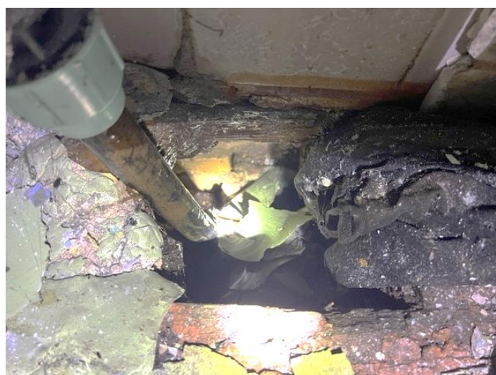
5.1.3.att. Cauruļvadu savienojuma vietas deformētas, veikti nekvalitatīvi remontu.
