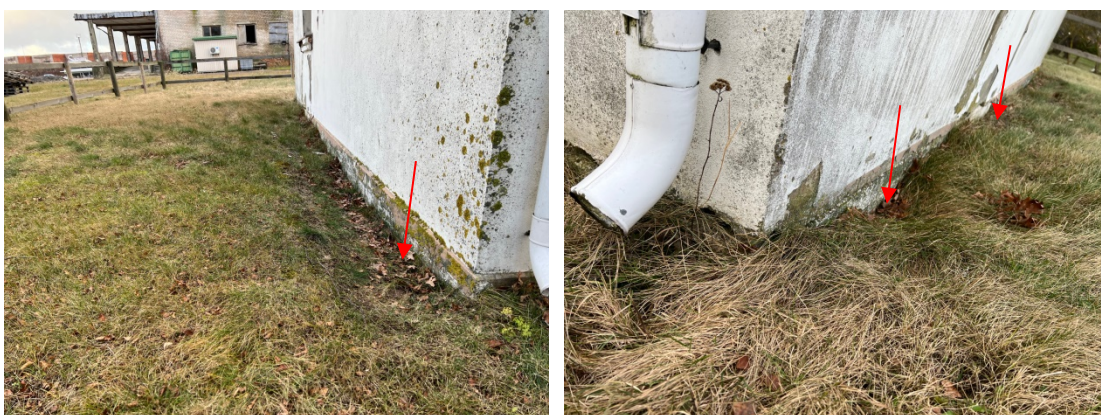
4.1.4.un 4.1.5.att. D pusē pie pamatiem krājas ūdens, grunts līmenis ir augstāks ar kritumu uz ēkas pamatiem.
