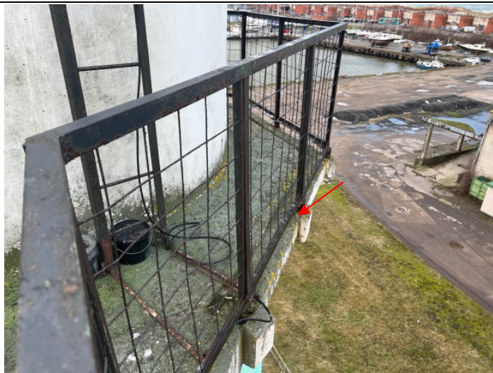
4.20.23.att. Lokāli konstatēti bojājumi, plaiss stiprības ribu konstrukcijā, kur stiprināti metāla margu stabiņi.
