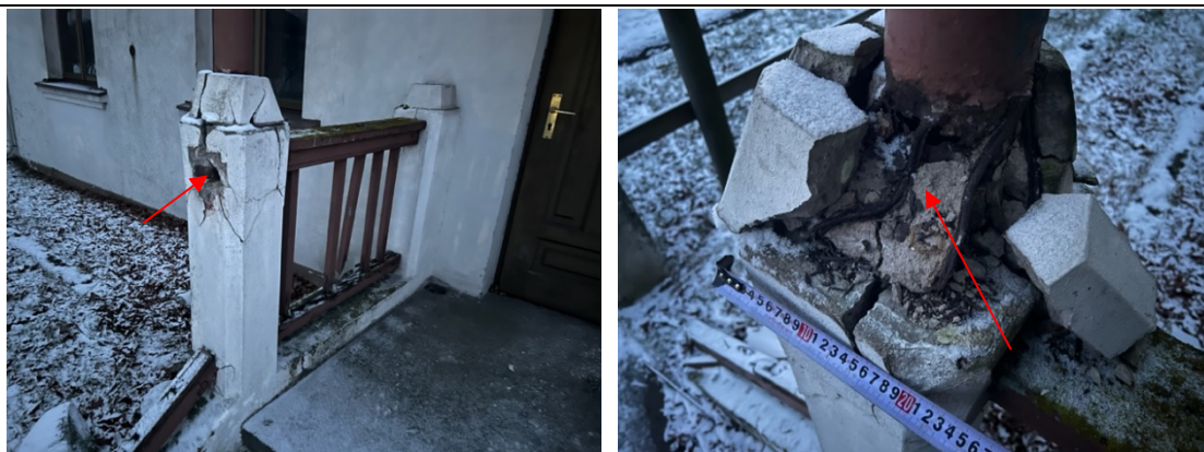
4.9.6.un 4.9.7.att. Margu betona stabiņiem uz kuriem balstās jumiņa metāla konstrukcija, konstatēti būtiski bojājumi, izdrupumi.
