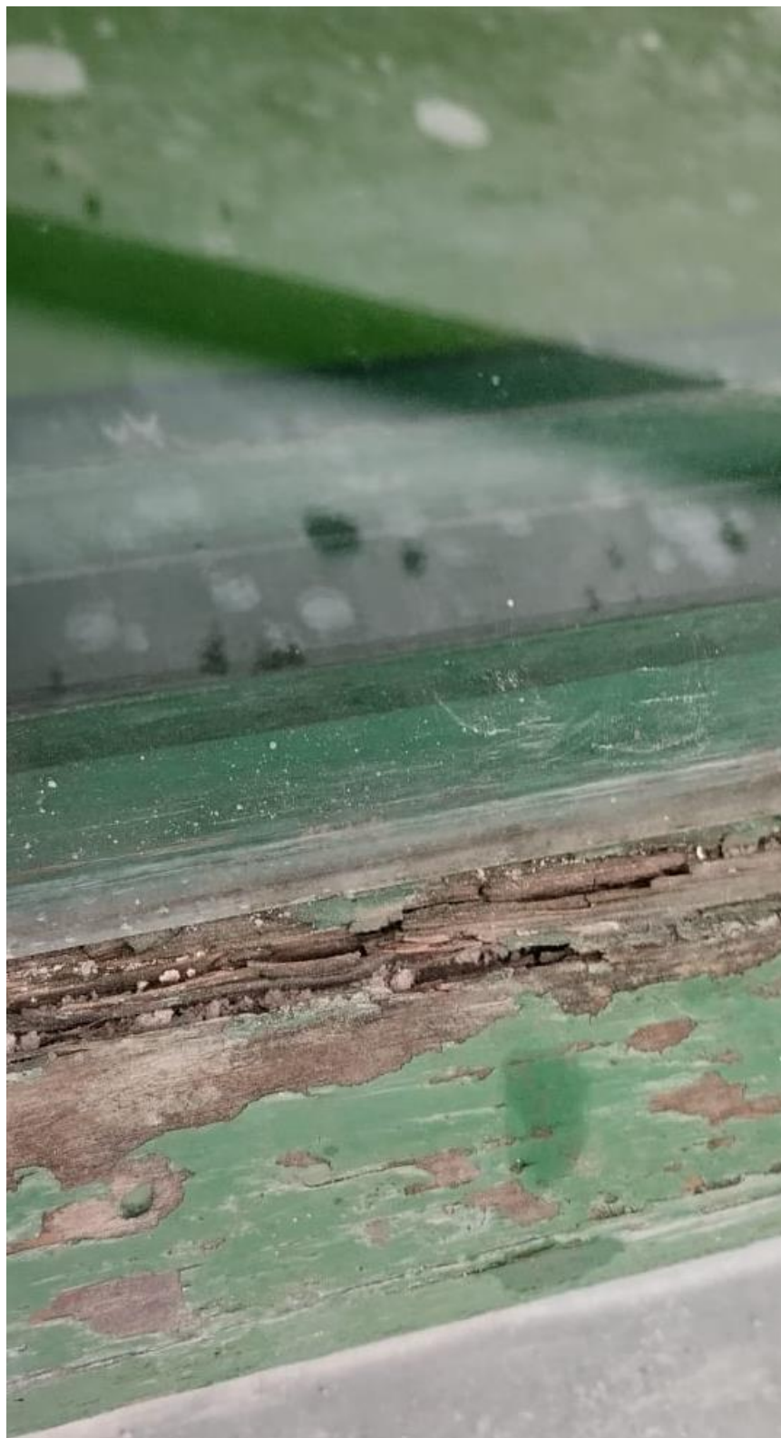
4.līdz 12.att .Koka logu bojātie elementi.
