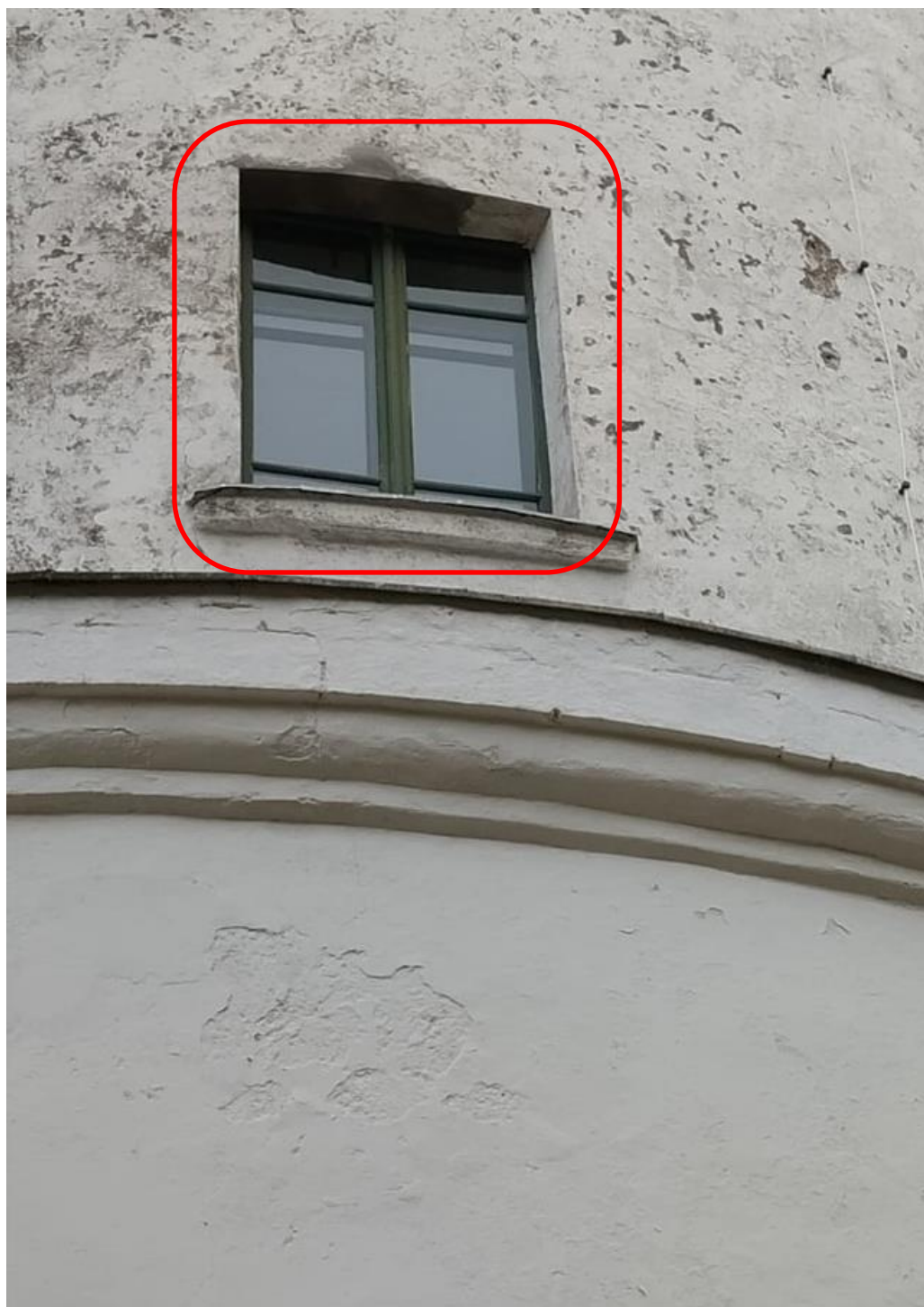
1.att .Bojātais koka logs (rietumu pusē). 3.stāvs
